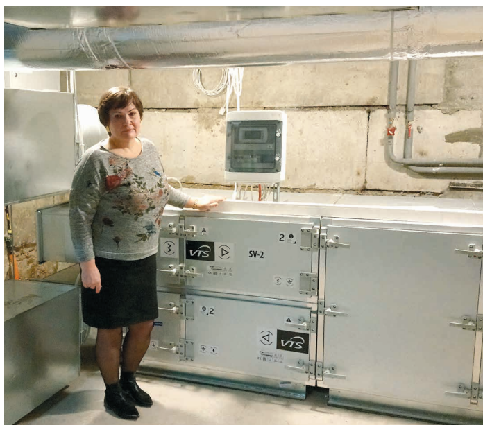
Директор социального центра Карьякюла Тийу Неттан представляет находящееся в подвале социального центра вентиляционное оборудование с рекуперацией тепла.
